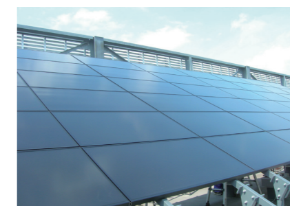
太陽光パネル Solar panels
